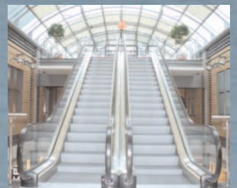
Aufzugsbau, Fahrtreppen Lifts and escalators
