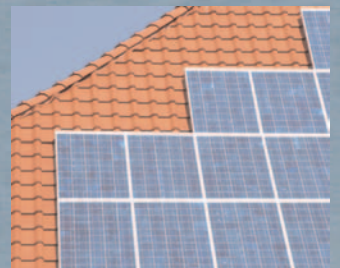
Solartechnik, Kabelkanäle Solar technology and cable ducts
